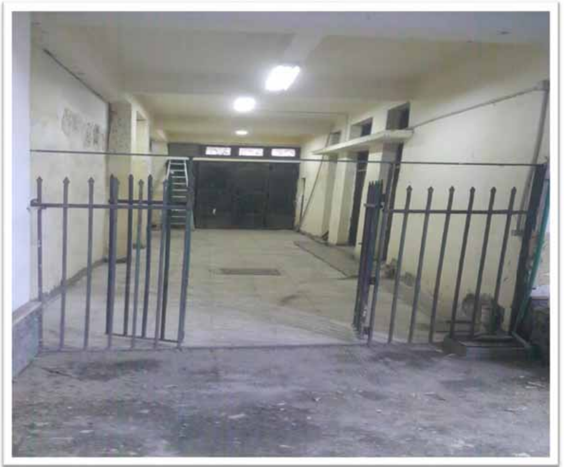
البوابة ومدخلها بعد تمام إجراء جميع الإجراءات التصحيحية بها
